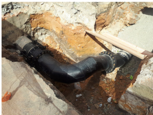
Interligação Saída da Estação de Bombeamento
